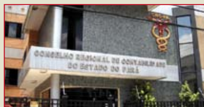
Na primeira foto ao lado, a rachadura que atingiu a atual sede do CRC. Na segunda imagem, o prédio após a reforma
